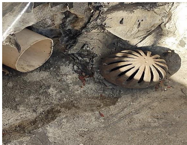
Foto 2- Ralo tipo abacaxi com infiltração;
