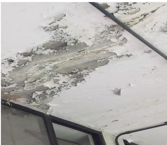
Foto 5 - Infiltração no teto provocado por trinca;
