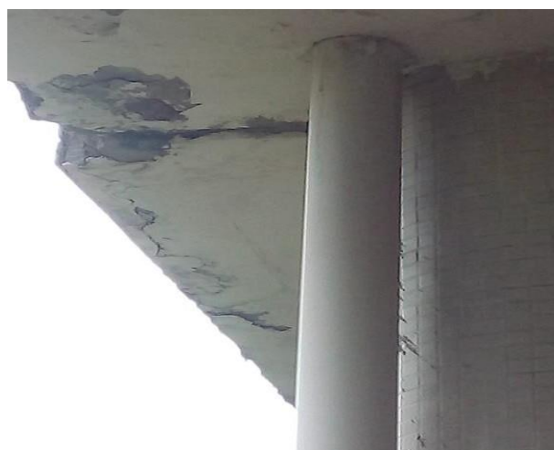
Foto 6 - Estrutura danificada pela infiltração;
