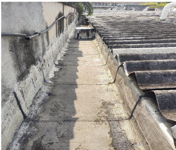
Foto 7 – Telhas quebradas e menores, provocando retorno de água pluvial;
