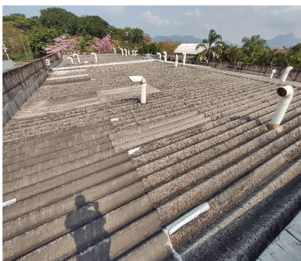
Foto 9 – Telhas de tamanhos diferentes e rachadas
