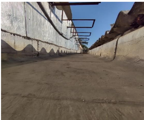
Foto 1- Calha de 52mx,90, com manta danificada;
