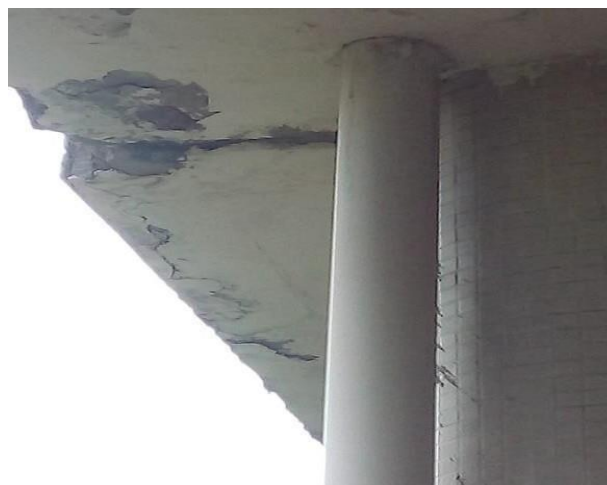
Foto 6 - Estrutura danificada pela infiltração;
