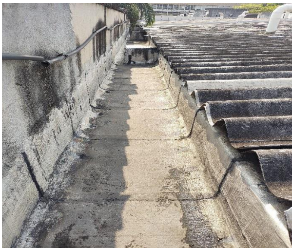
Foto 7 – Telhas quebradas e menores, provocando retorno de de água pluvial;
