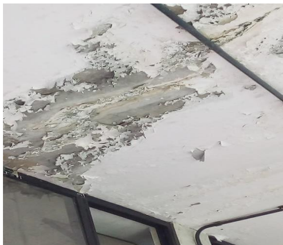
Foto 5 - Infiltração no teto provocado por trinca;
