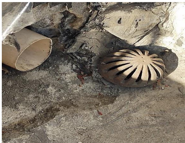
Foto 2- Ralo tipo abacaxi com infiltração;
