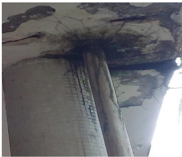
Foto 4 -Infiltração no dreno e na junta de dilatação;
