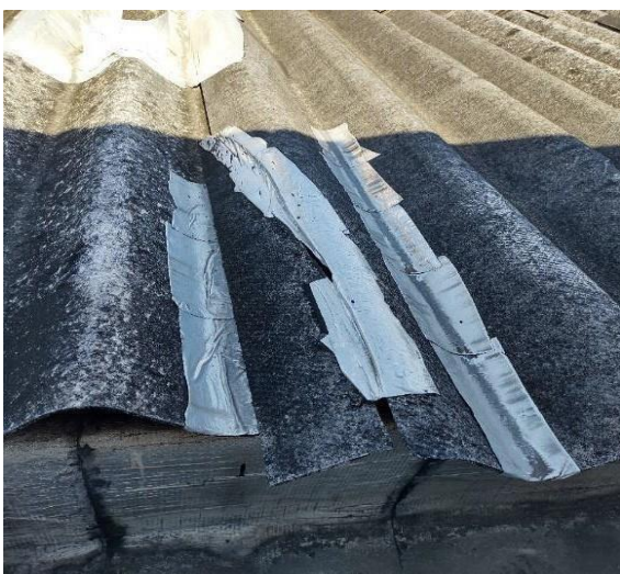
Foto 3 - Telhas quebradas e remendadas;
