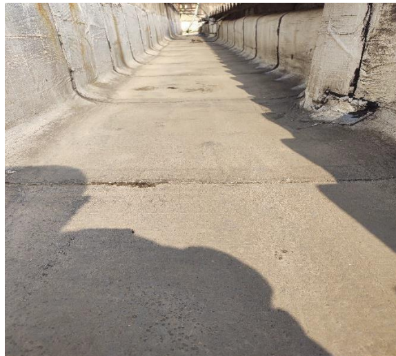
Foto 10 – Manta remendada com infiltração
