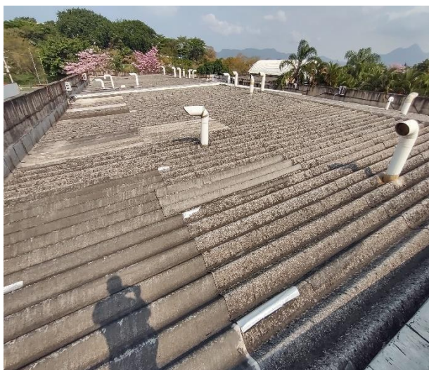
Foto 9 – Telhas de tamanhos diferentes e rachadas
