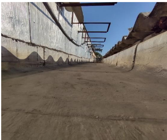
Foto 1- Calha de 52mx,90, com manta danificada;
